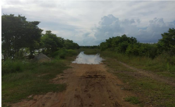
Gambar 1. 1 Kondisi Ruas Jalan Sungai Malang – Pamintangan
